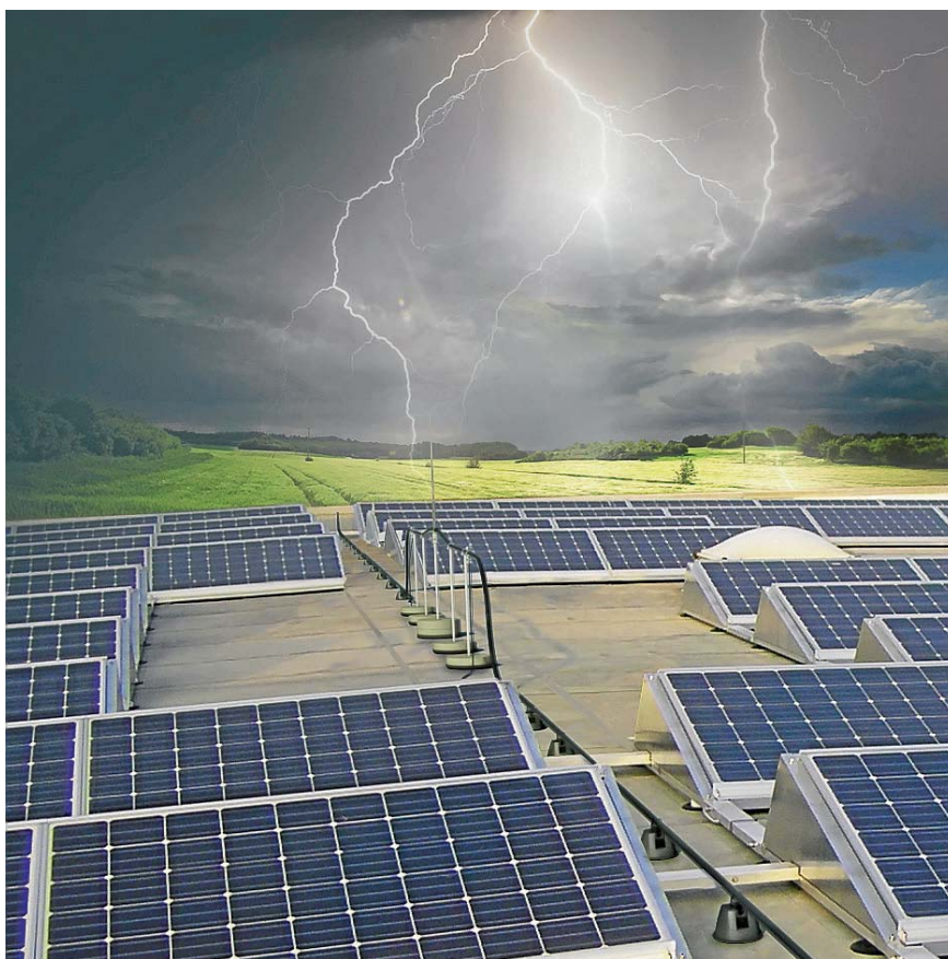
Blitzschutz bei PV-Anlagen ist eine anspruchsvolle Aufgabe sowohl für die Planung und Ausführung als auch für die zu verwendenden Geräte und Leitungsführungen. (Bild: OBO Bettermann)
